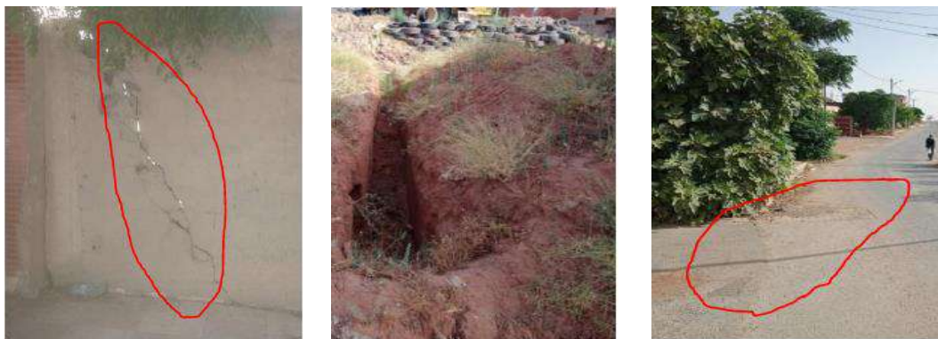
Figure1. Les dégradations observées au voisinage du site d'implantation
